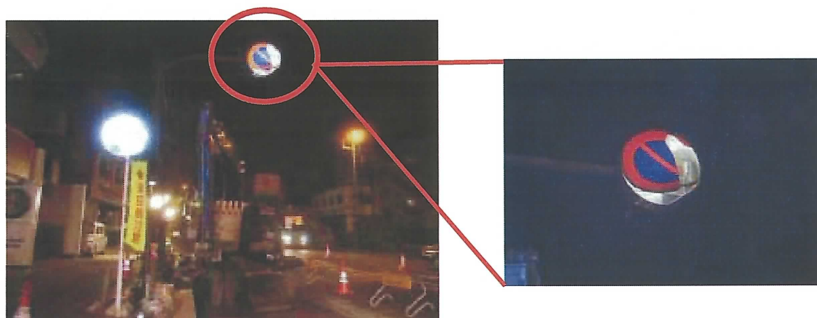
標識損傷状況
