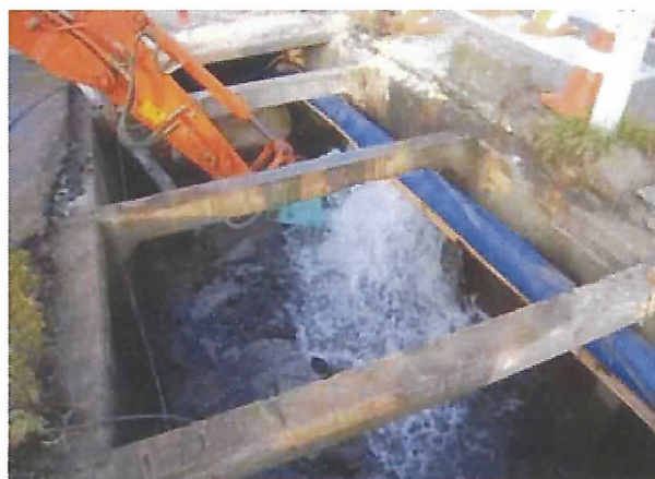
水道管破損直後
