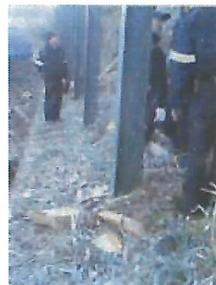
法面下部の落石防護柵
