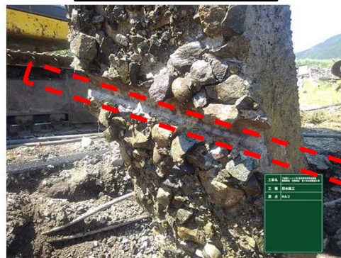
水道管付着状況
