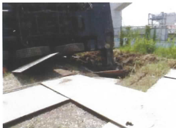
アウトリガー陥没状況
