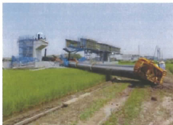
クレーン転倒状況
